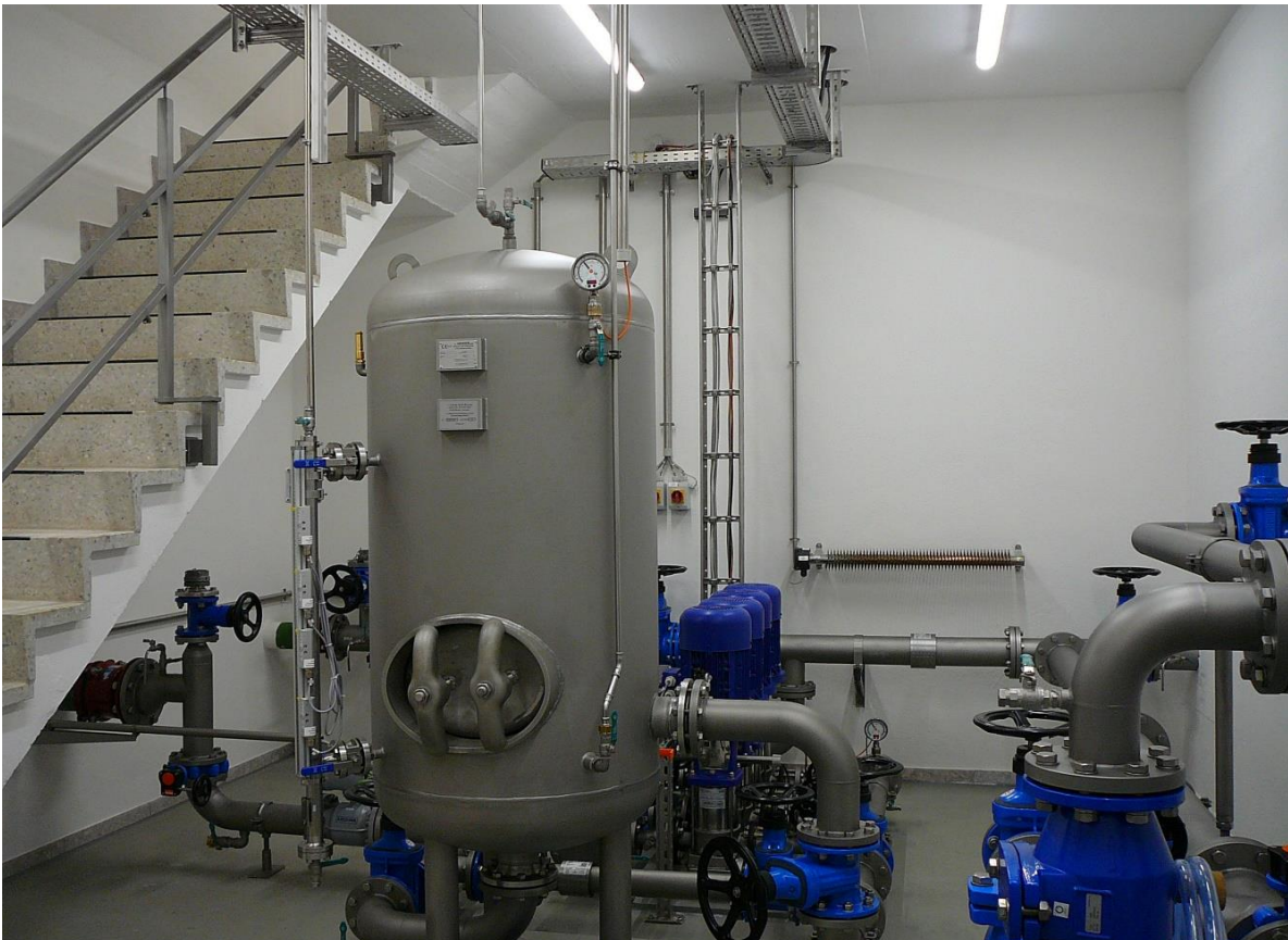
Neue Pumpentechnik im Untergeschoss
